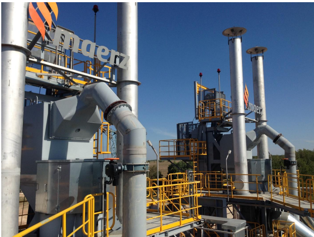
Рис. 4. Обжиговые печи HPS компании MAERZ
