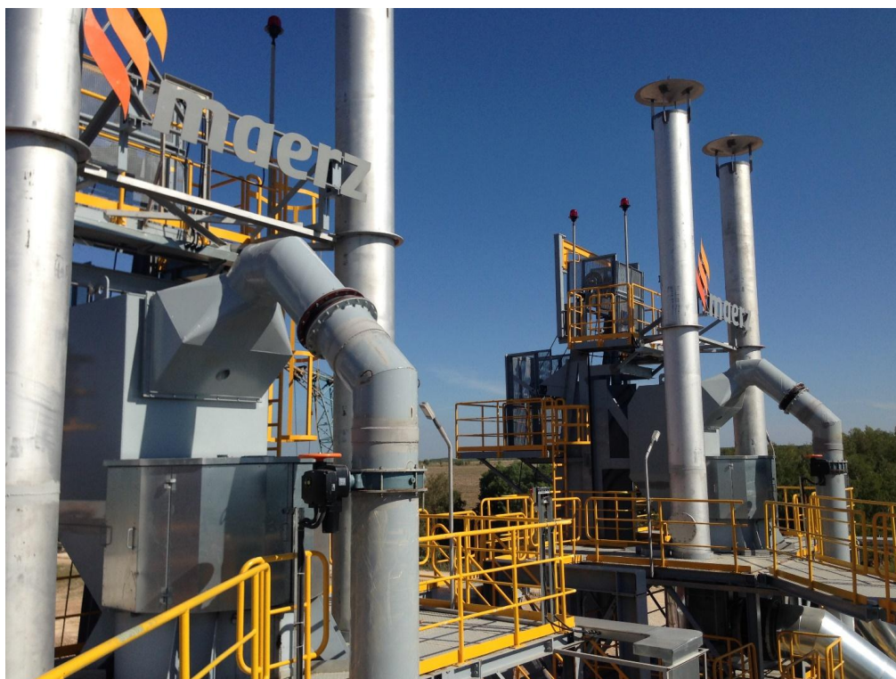
Рис. 4. Обжиговые печи HPS компании MAERZ
