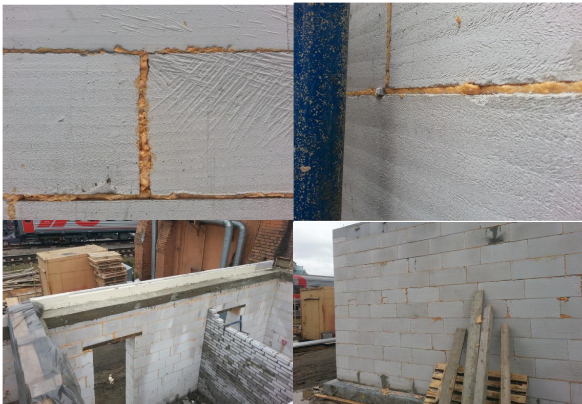
Рис. 3. Некачественная кладка с перерасходом клея
