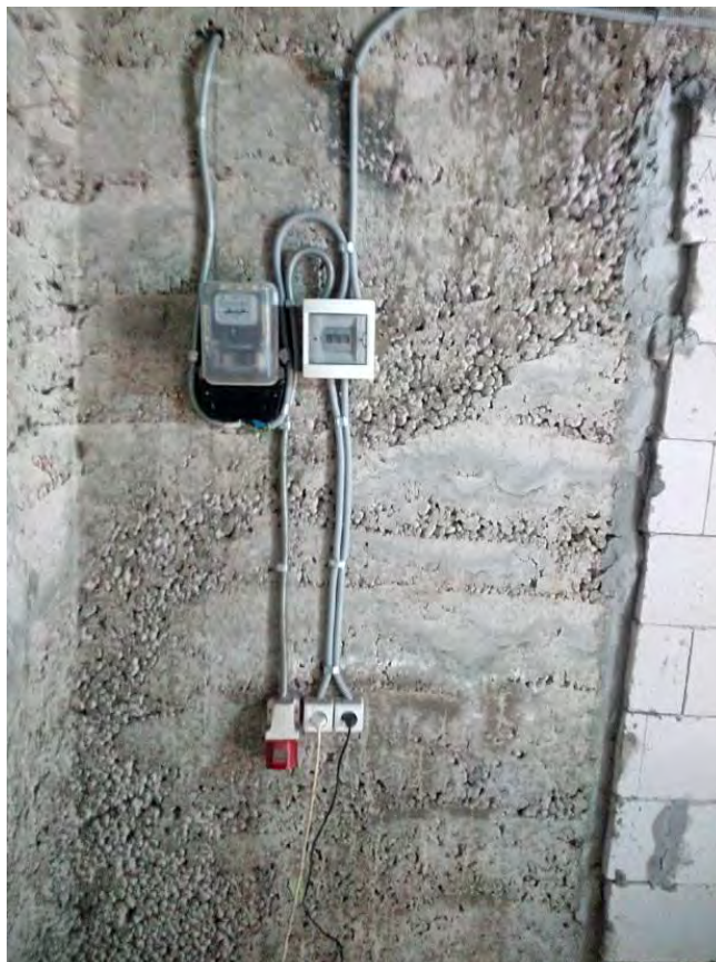
Рисунок 7 – Електричне живлення будинку з лічильником
