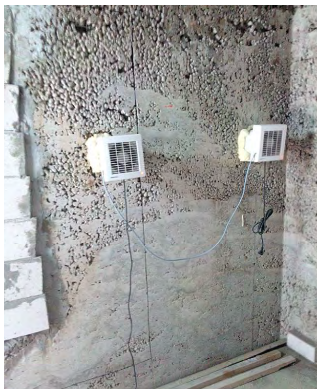
Рисунок 4 – Вмонтовані в стіну вентилятори з рекуперацією тепла
