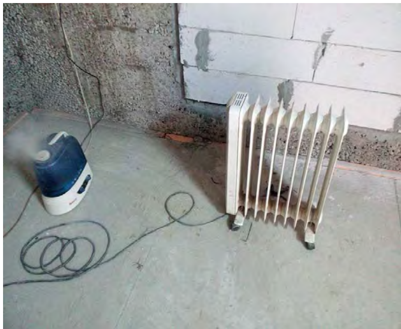
Рисунок 5 –Електричний зволожувач повітря та нагрівальний радіатор
