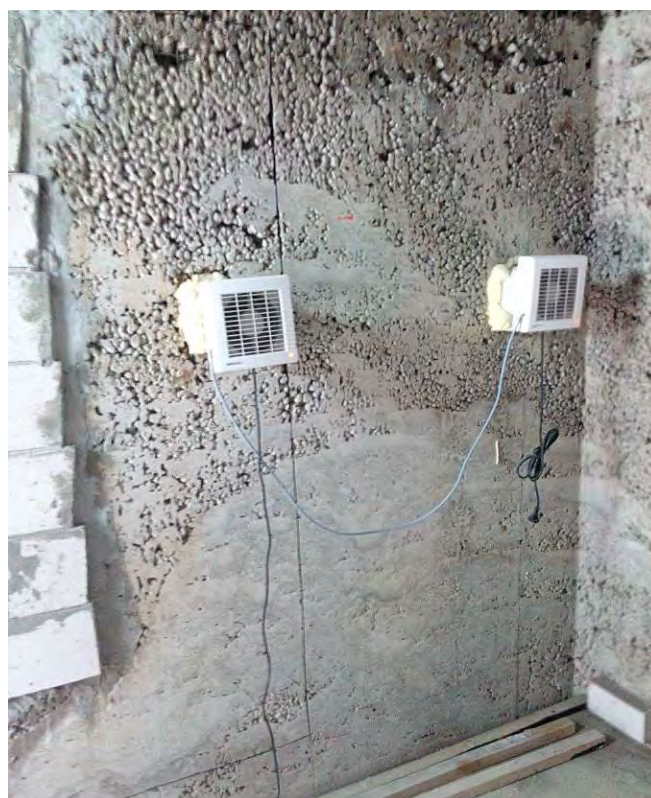
Рисунок 4 – Вмонтовані в стіну вентилятори з рекуперацією тепла
