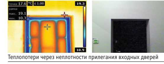
Теплопотери через неплотности прилегания входных дверей
